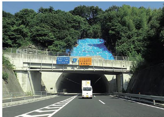
トンネルの上部にブルーシート(福山市神村町)
