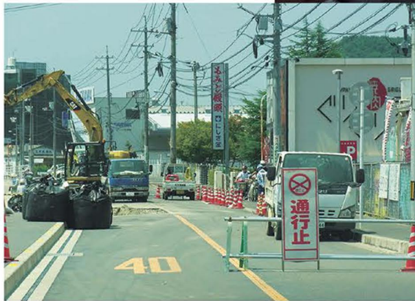
道路が陥没し通行止めに(広島県海田町)
