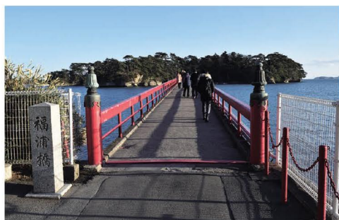
福浦橋、橋脚が津波で壊された
