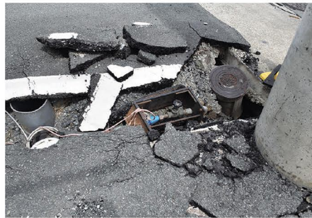
強い揺れでアスファルトが持ち上がった
