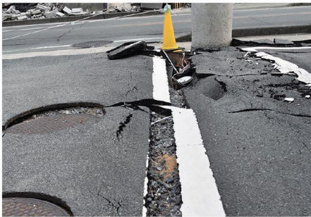
段差が出来ていた
