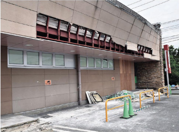
壁が落ちている
