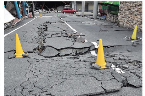
亀裂が広がる
