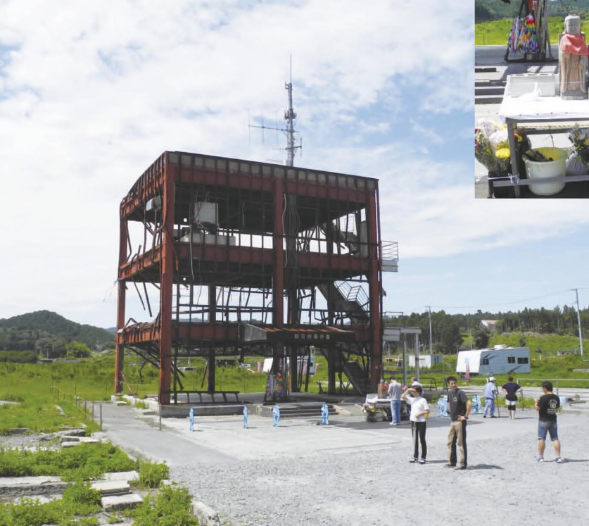
鉄骨だけが残った防災庁舎
