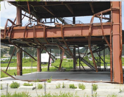
ねじ曲げられた鉄骨が津波の力を物語っている
