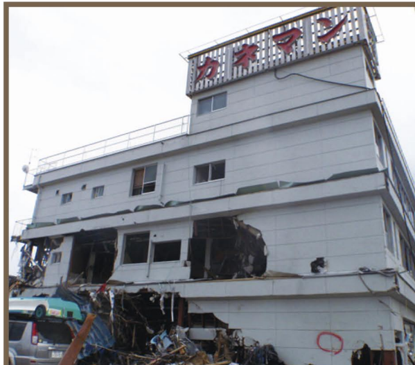
本社の外壁だけが残った
