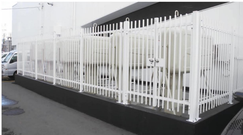
ロードヒーティング用の灯油タンク
