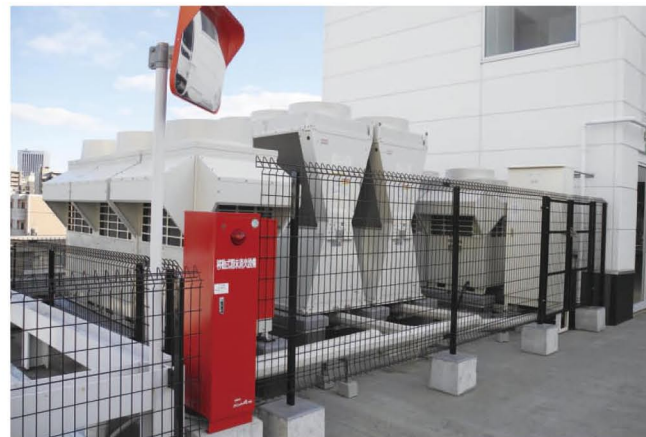
室外機は駐車場に設置されている
