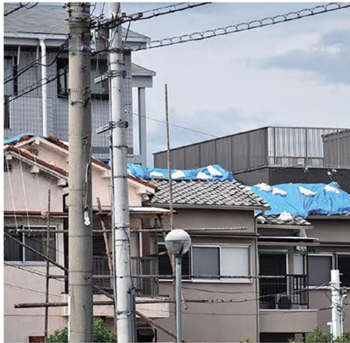
ブルーシートで補修した屋根が点在する
