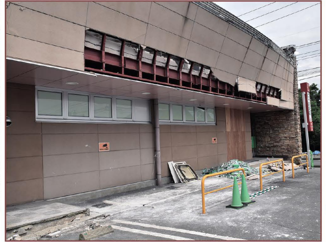
壁が落ちていた(当時)
