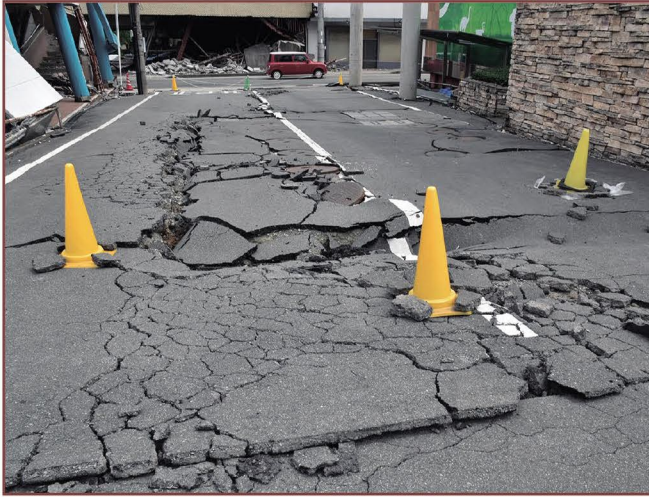
亀裂が広がっていた(当時)
