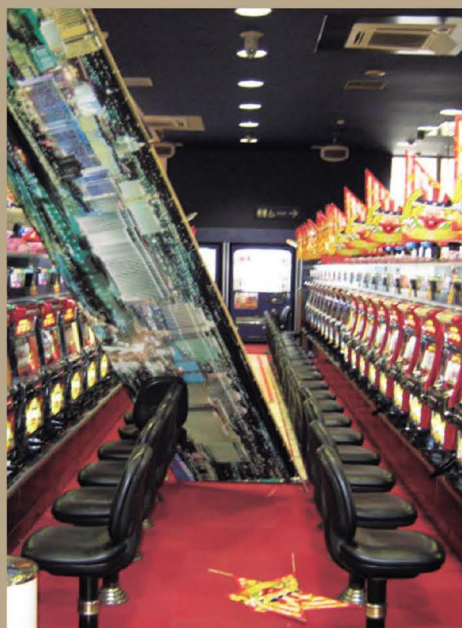
仕切り板が落下
